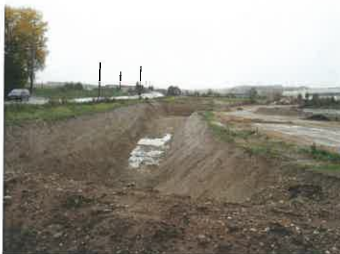
Figure 12 : Bassin d'orage de la Zone d'activité de OYTIER-ST-OBLAS
